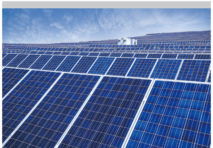
甘肅嘉峪關光伏電站
