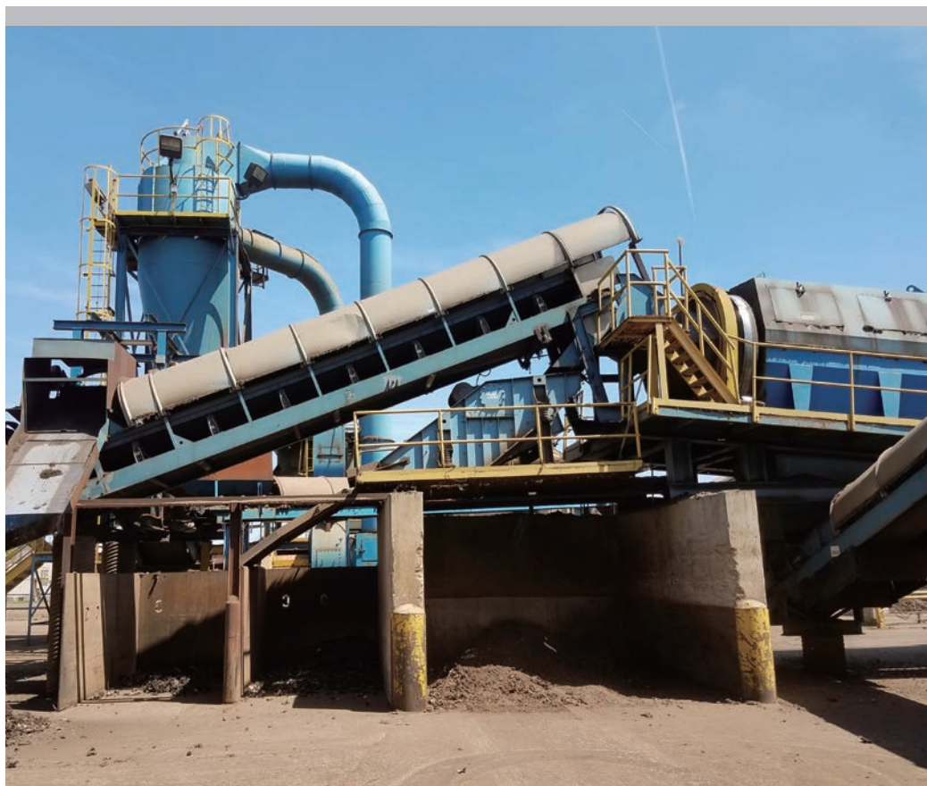
齊合環保先進設備。
