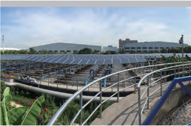
雲南水務屋頂分佈式光伏發電項目
