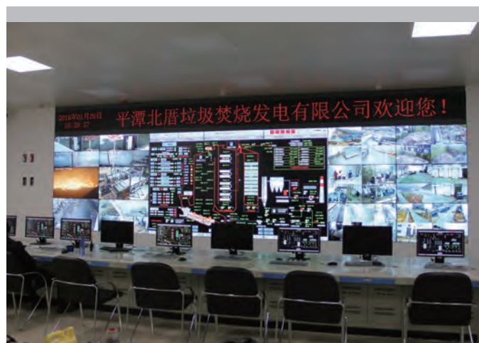
福建平潭北厝垃圾焚燒發電廠
